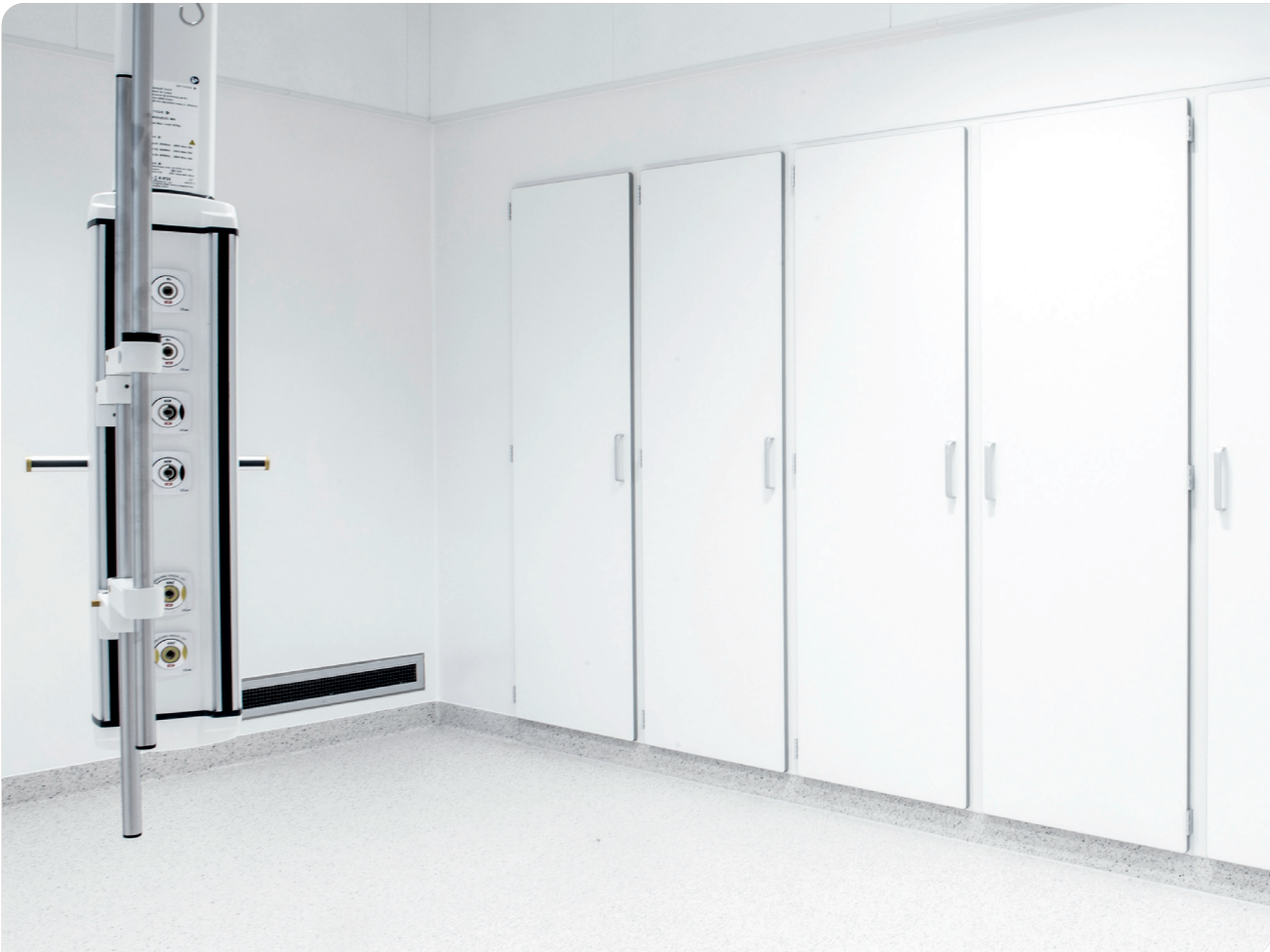
40/60 modulaire doorvoerkasten, gezien vanaf de zijkant van de operatiekamer
