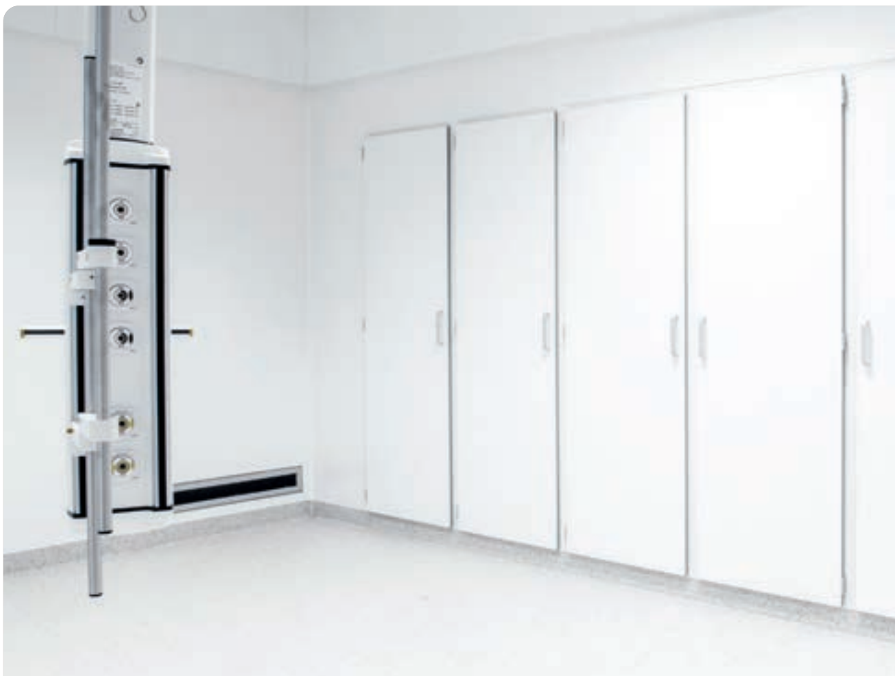
Armarios de paso modulares de 40/60 vistos desde el lateral del quirófano
